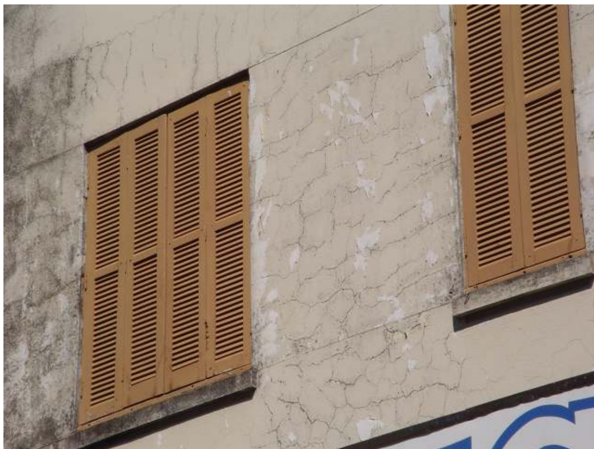
Figura 1: fissuras do tipo mapeada em um prédio na cidade de Sant´Ana do Livramento
