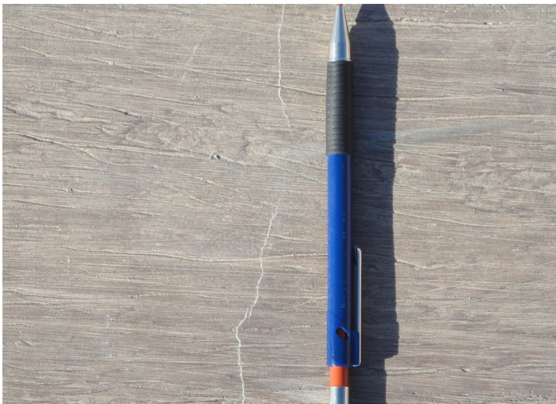
Figura 42: Fissuras que aconteceram nas placas padrões – STD. Fonte: Autor.
